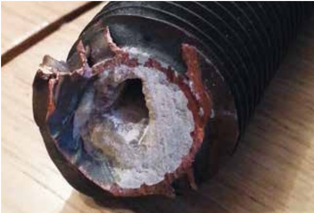
Verkalkter Kupfer-Rippenrohr-Wärmetauscher aus einem Pufferspeicher
