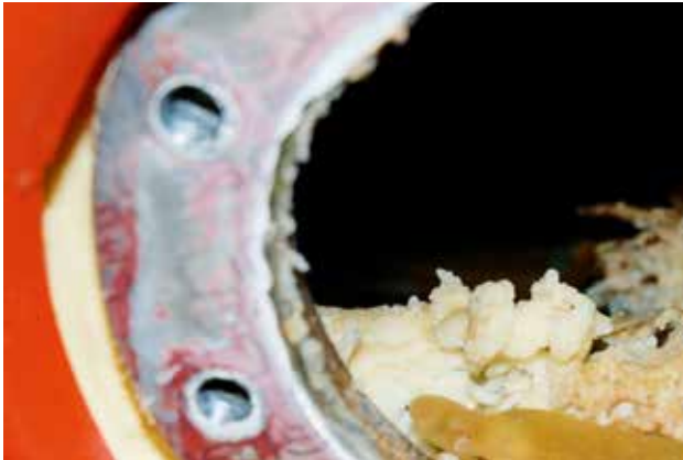
40 Zentimeter hohe Kalkablagerungen auf dem Speicherboden im Warmwasserspeicher
