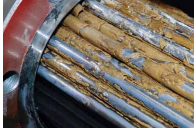
Rohrbündelübertrager mit Kalkablagerungen
